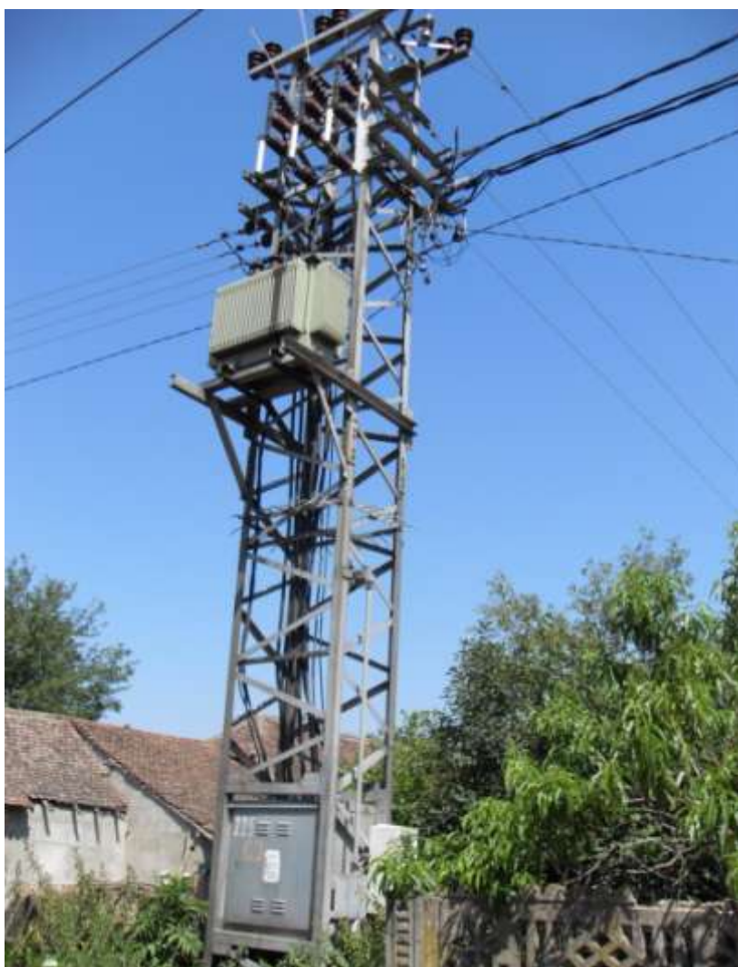
Сл.58 Изглед СТС (решетка) „Сараорци 4“
