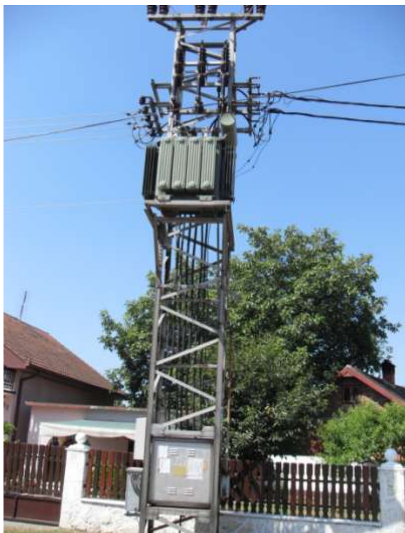
Сл.55 Изглед СТС (решетка) „Сараорци 3“
