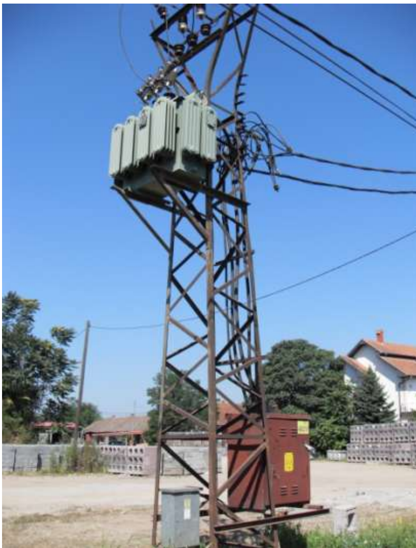
Сл.52 Изглед СТС (решетка) „Сараорци 2“
