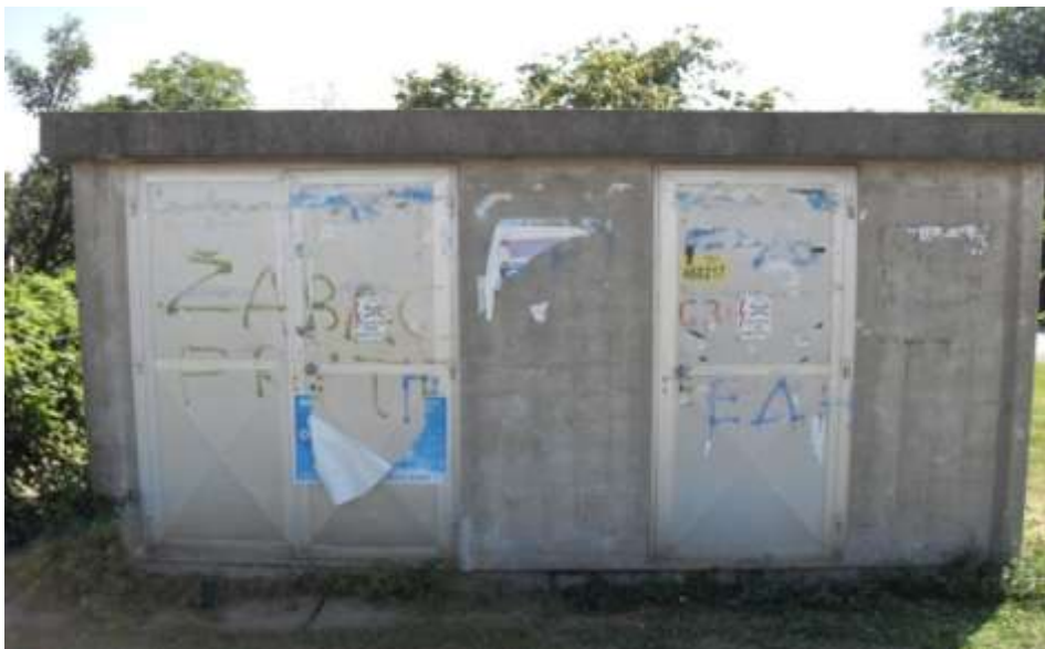
Сл.46 Изглед МБТС „Лугавчине 5“
