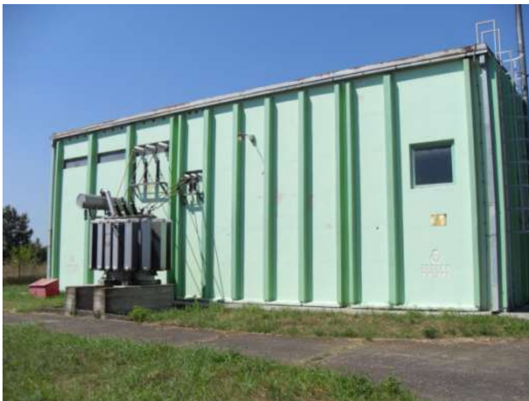
Сл.71 Изглед ТС Смедерево 12 „Лугавчина 35/10kV „
