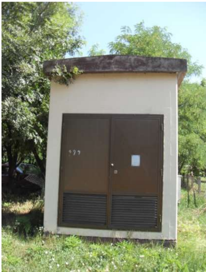
Сл.64 Изглед МБТС „Сараорци 6“
