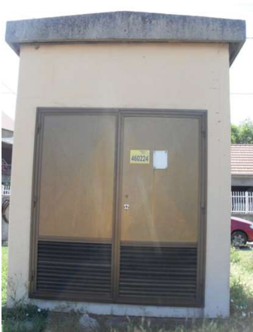
Сл.67 Изглед МБТС „Сараорци 7“
