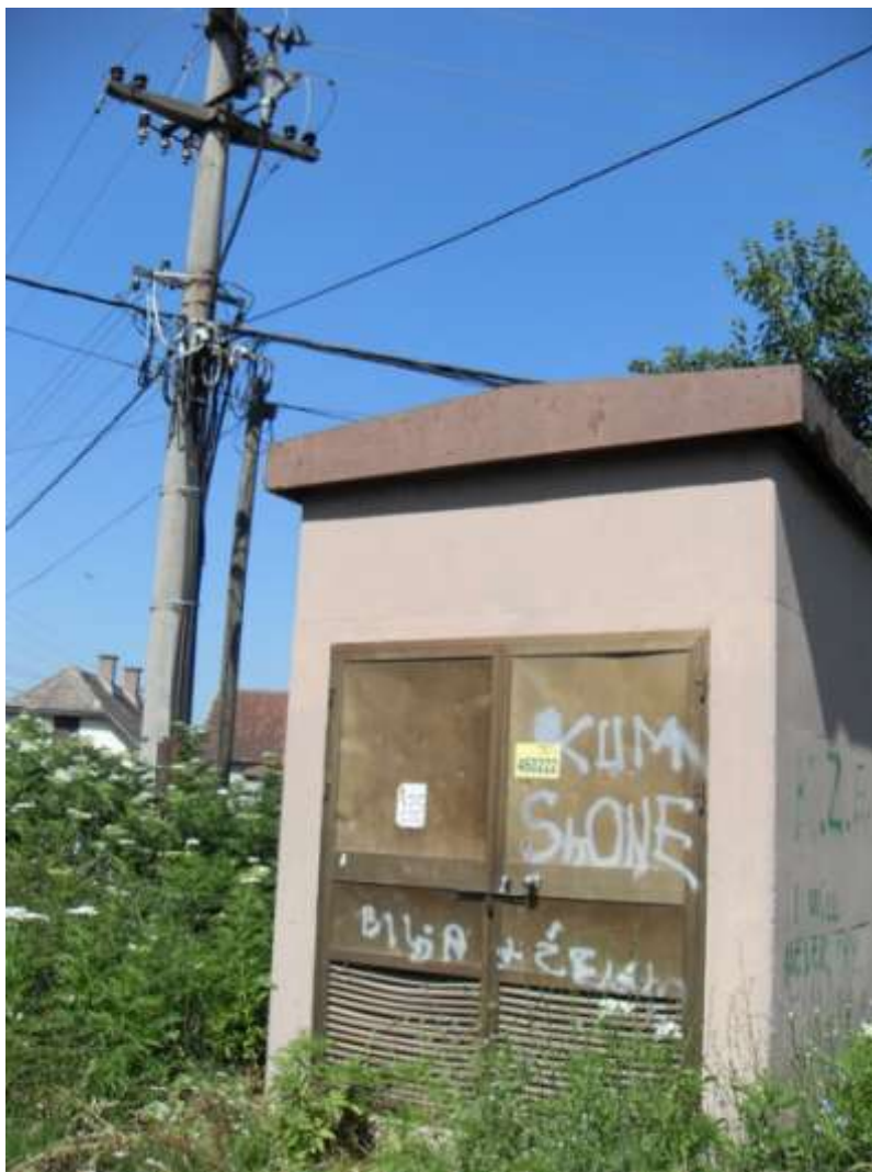
Сл.61 Изглед МБТС „Сараорци 5“
