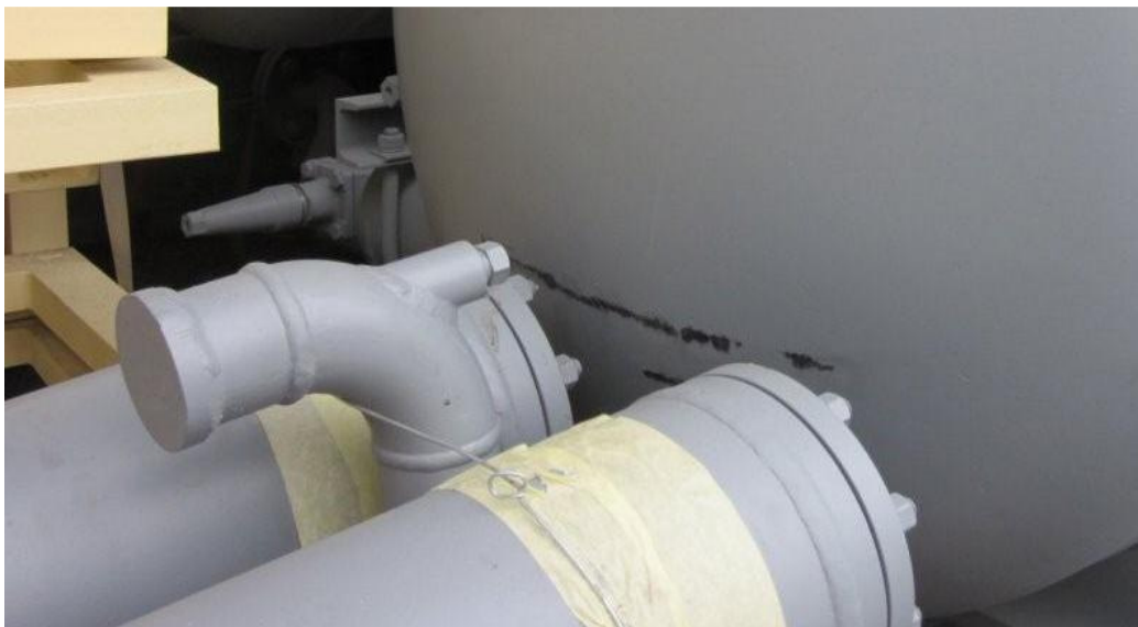
Silka 26: Fizičko oštećenje nastalo u transportu gotovih proizvoda
