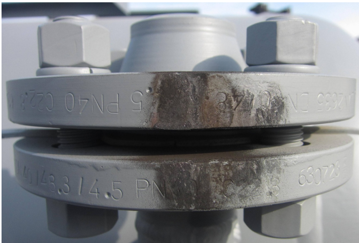
Slika 25: Oštećene prirubnice u toku transporta posude kranskom dizalicom
