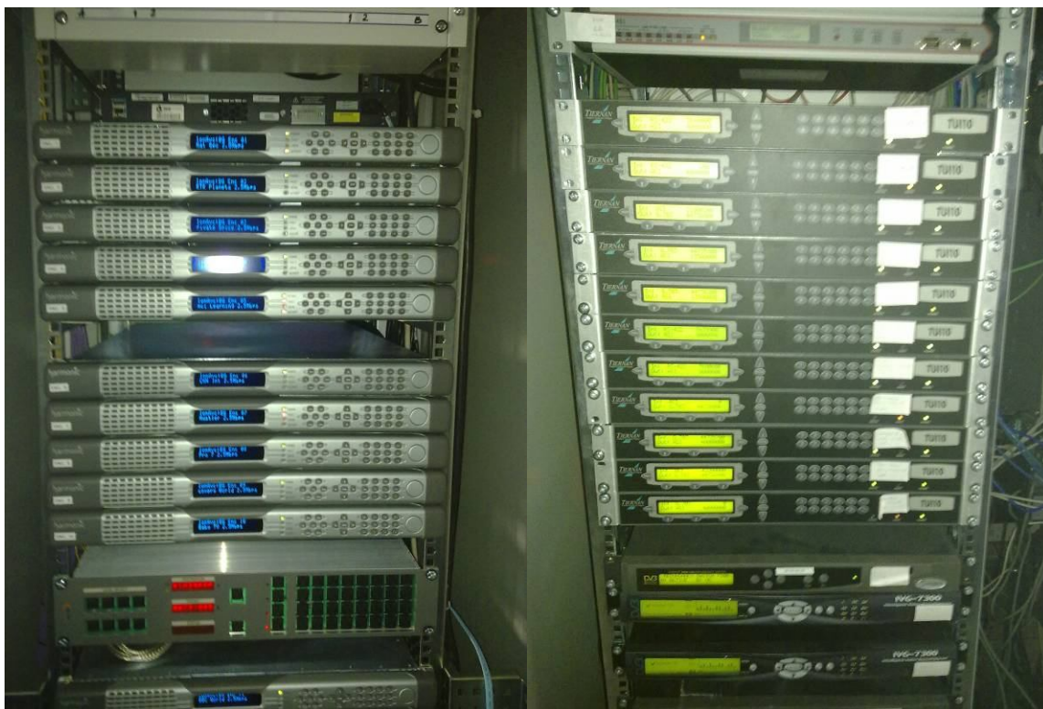
Slika 14.4. – Enkoderi u Headend-u Telekom Srbija
