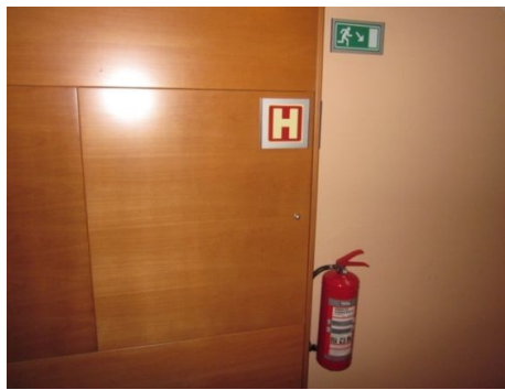
2. Hidrantska mreža, protivpožarni noseći aparati
