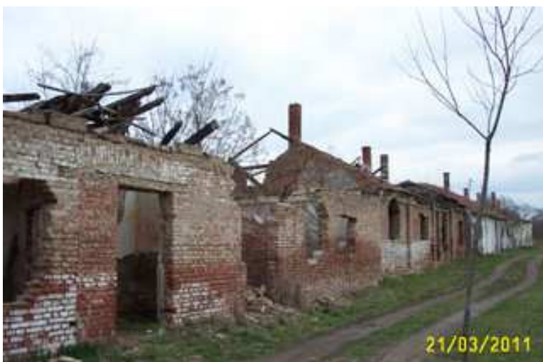
Srušeni magacini, desno, u nastavku je polusrušena stolarska radionica
