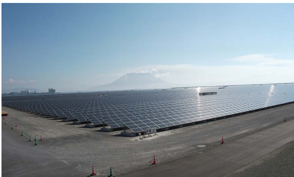
Slika broj 6: SMA Solar Technology AG 36 – jedini dobavljač pretvarača za projekat snage 70 kilovata u Kagošimi
