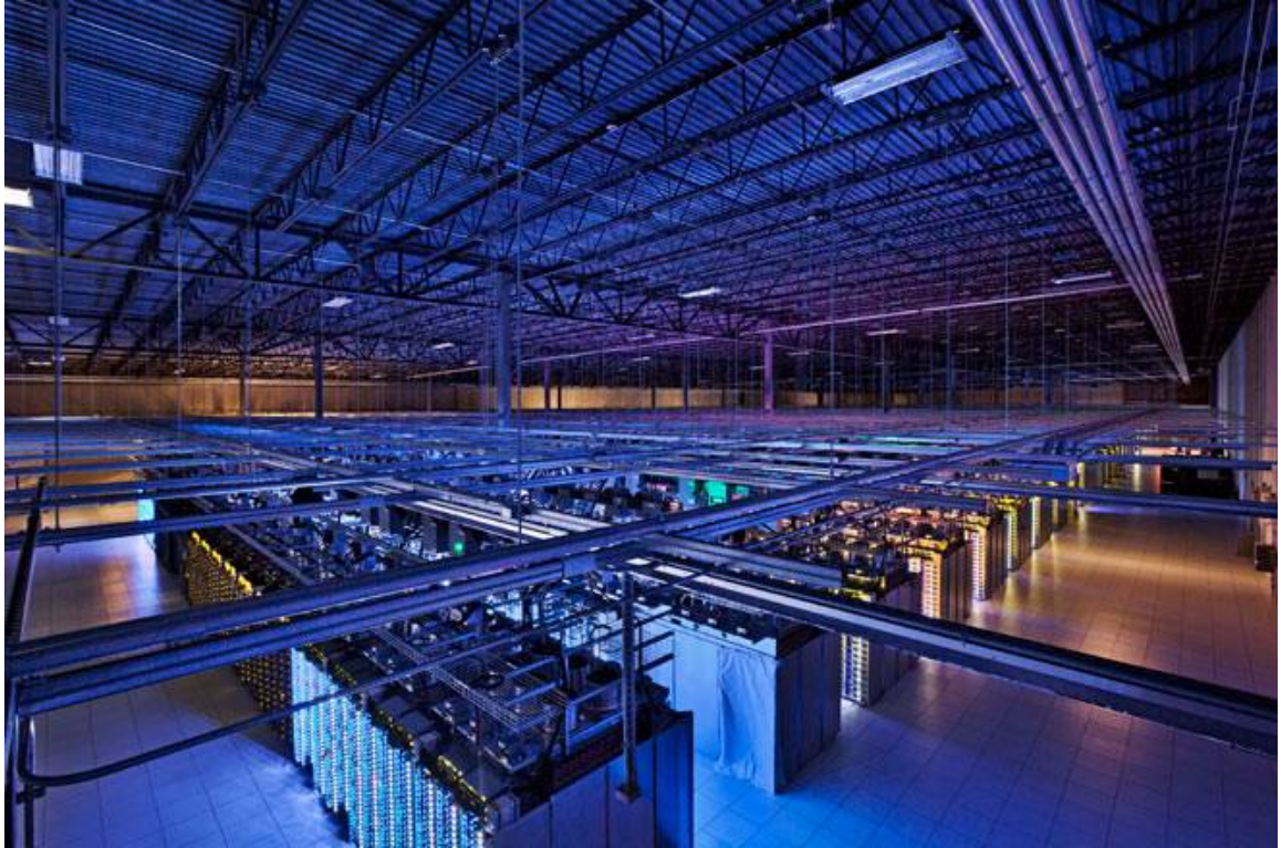
Slika 3. Serverska soba. Datacentar Council Bluffs
