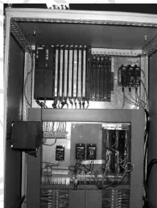
Sl. 10.12 PLC upravljačka ploča
